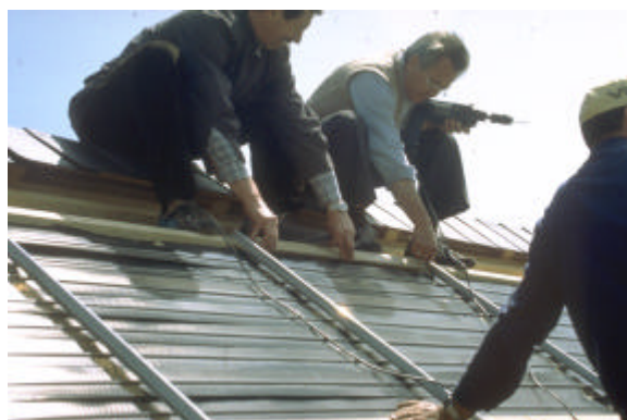
Figura 5.8: Collettore con strisce di assorbimento ad andamento orizzontale.
